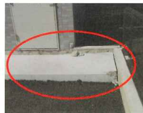
6階建マンション。建物の周りの地盤だけが沈下し、抜け上がりが発生。
