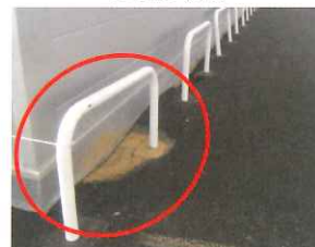
各所で液状化が発生。
