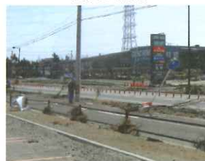
周辺は液状化や内部損傷が発生。
